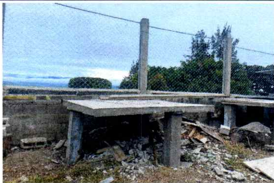
Foto 7: Abastecimiento de agua deficiente, en proceso de construcción de bases para Rotoplas para captación de agua pluvial.
